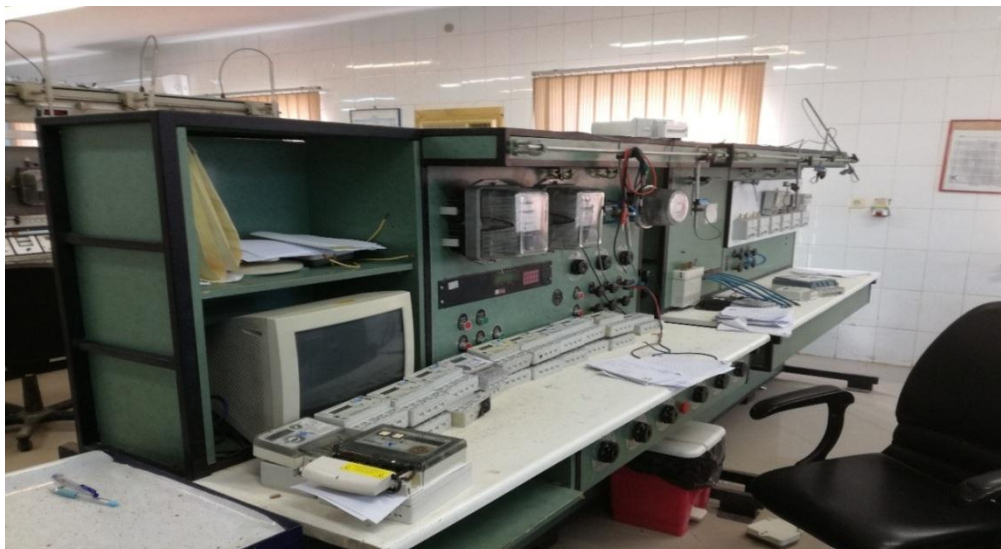
شکل ۴- تست نمراتور کنتور مشترک توسط تابلو ۲
