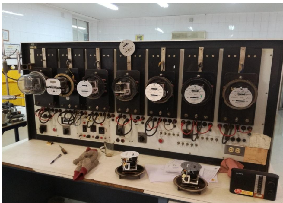
شکل ۵- تابلو تست بی باری ۲
