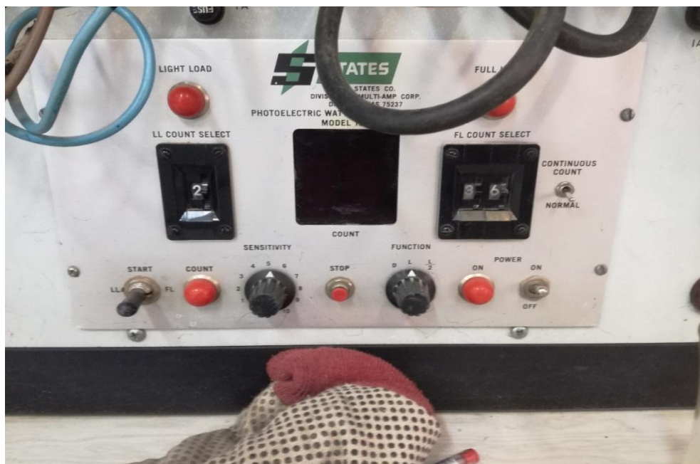
شکل ۶- تابلو تست بی باری ۲
